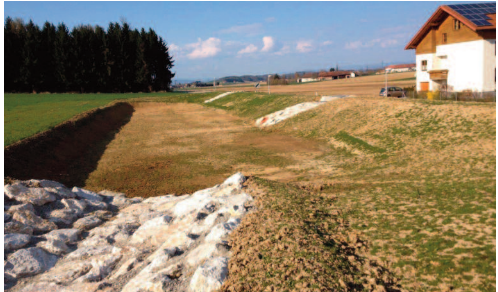
Abbildung 18 Versickerungsanlage (Quelle: Eitler & Partner)
